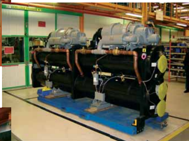
Fot. 14. Agregat chłodniczy przed komorą prób
